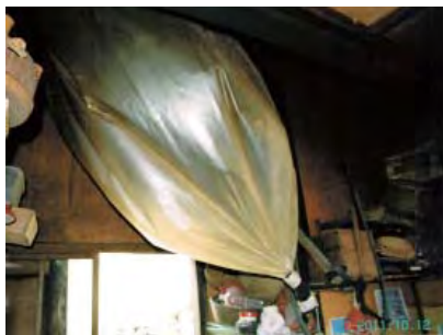
バイオガスのガスタンク
